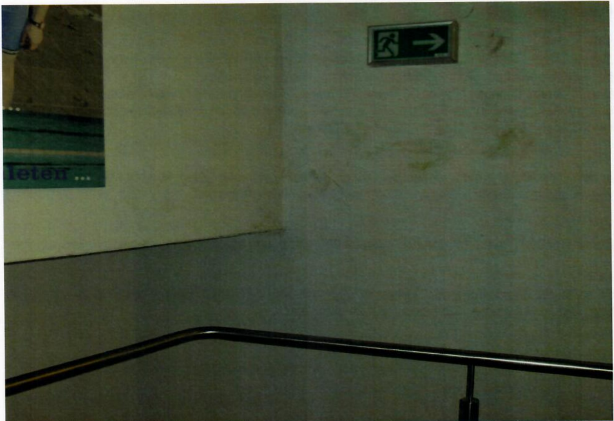
Foto 92_Elektro 14: Notbeleuchtung/ Sicherheitsbeleuchtung
