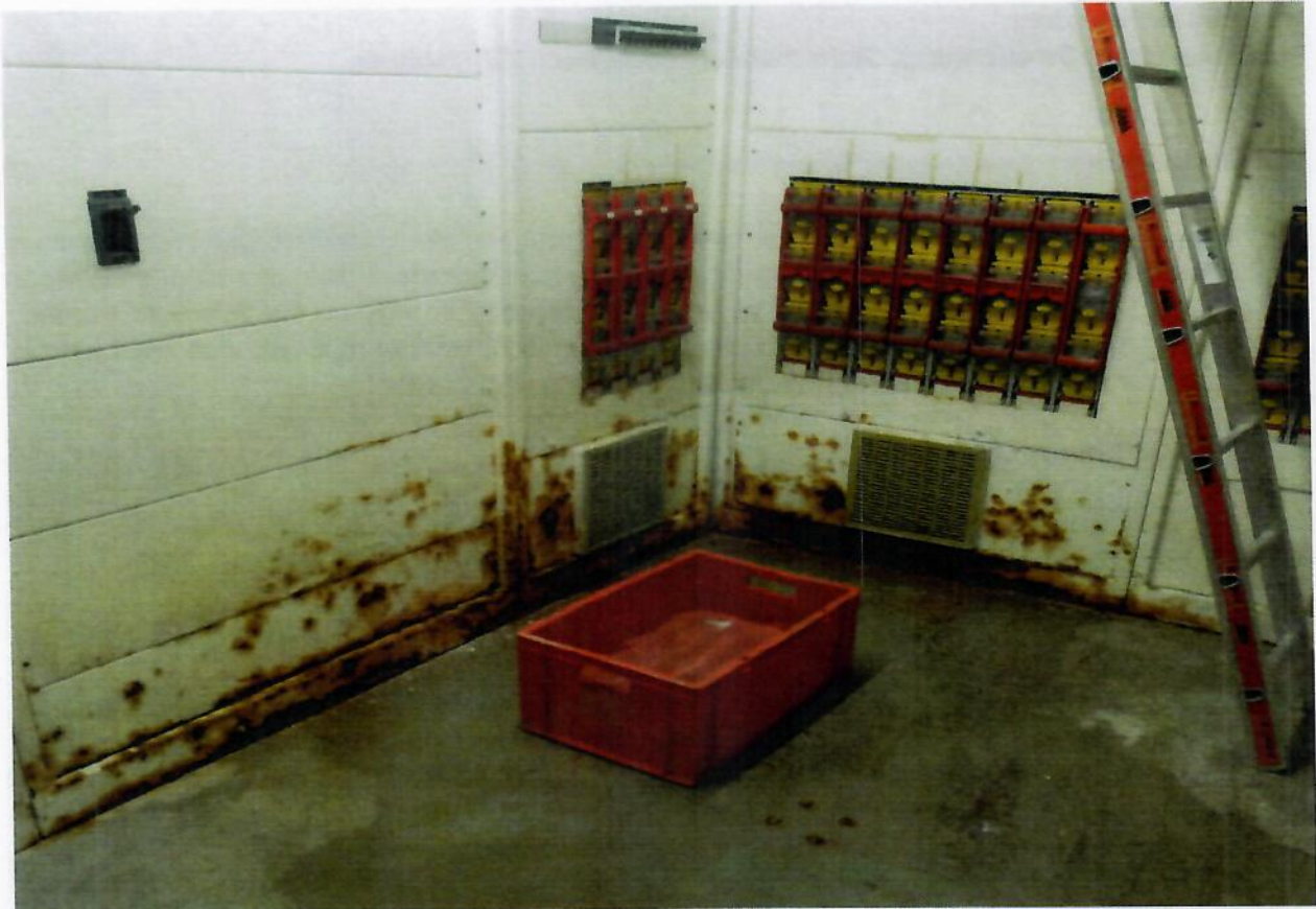
Foto 89_Elektro 14: Wassereintritt und Korrosion im Technikraum
