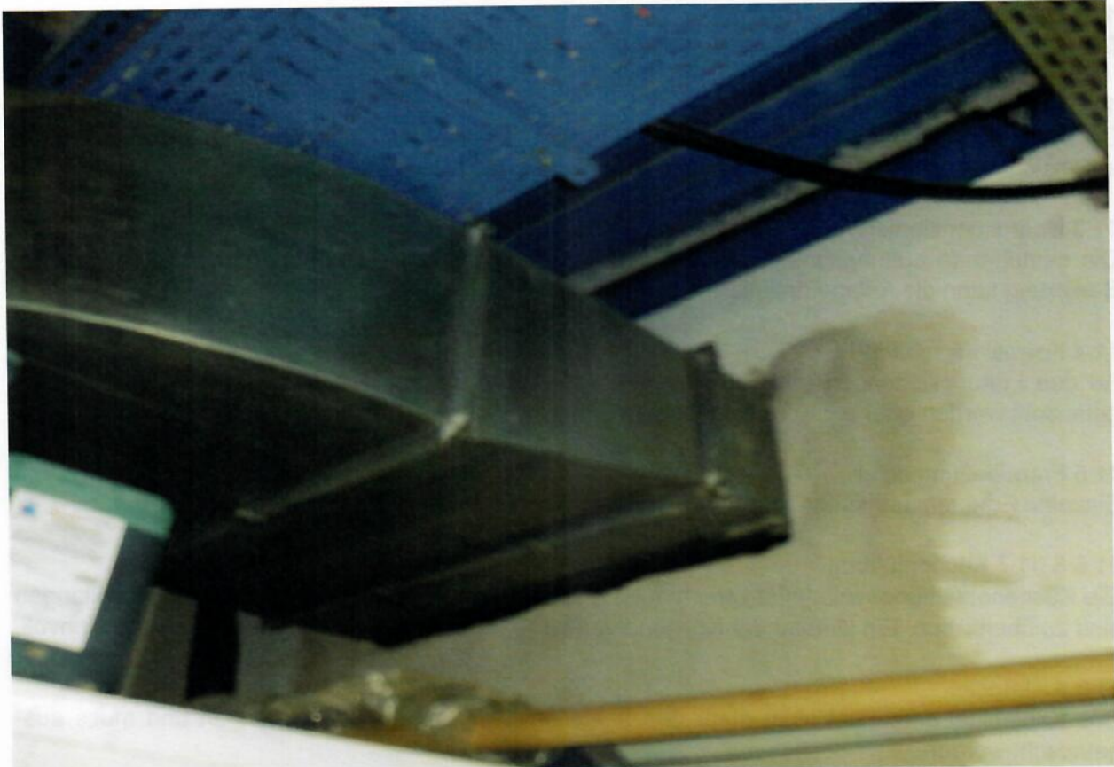
Foto 81_Lüftung 11: Mangelhafte Brandschutzdurchführung
