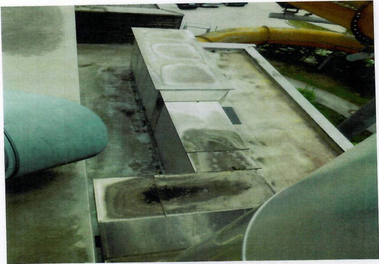
Foto 75_Lüftung 11: Lüftungsanlage im Bereich der Rutschen
