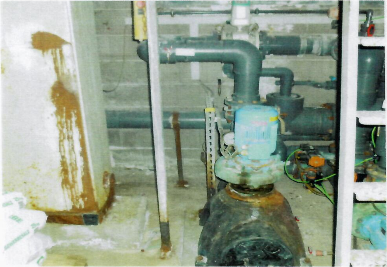
Foto 88_Sanitär 13: Korrodierte Pumpen
