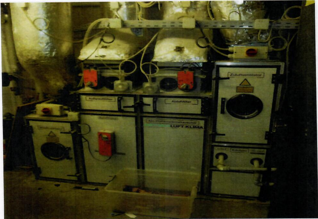
Foto 79_Lüftung 11: Lüftungsanlage Ruheraum
