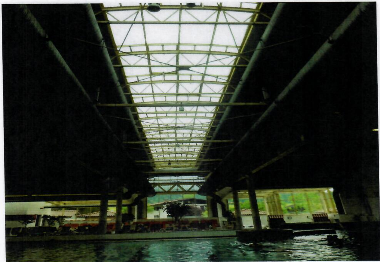
Foto 80_Lüftung 11: Korrodierte Aufhängung Lüftung Erlebnisbad
