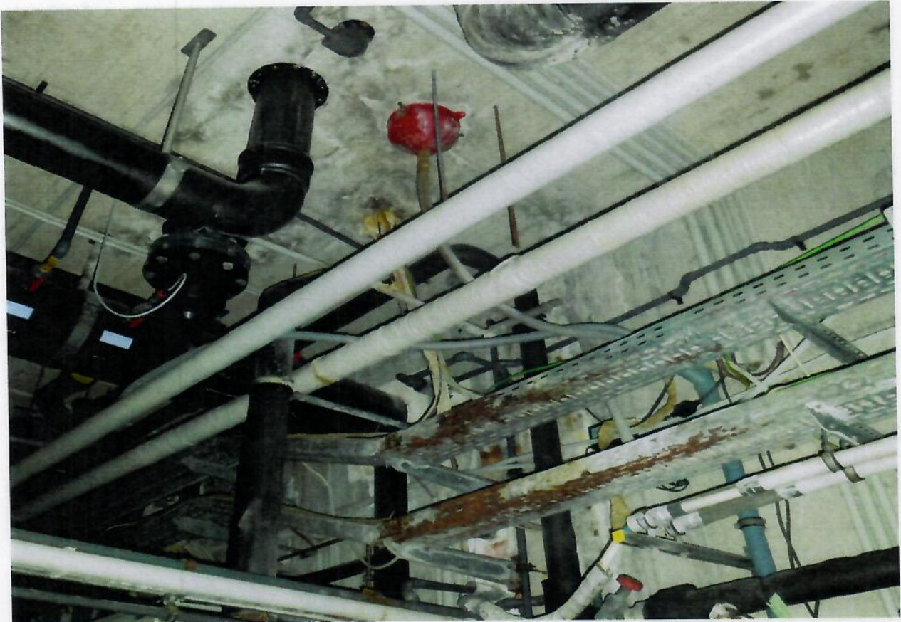
Foto 72_Badewassertechnik 10: Korrodierte Leitungen und Anschlüsse
