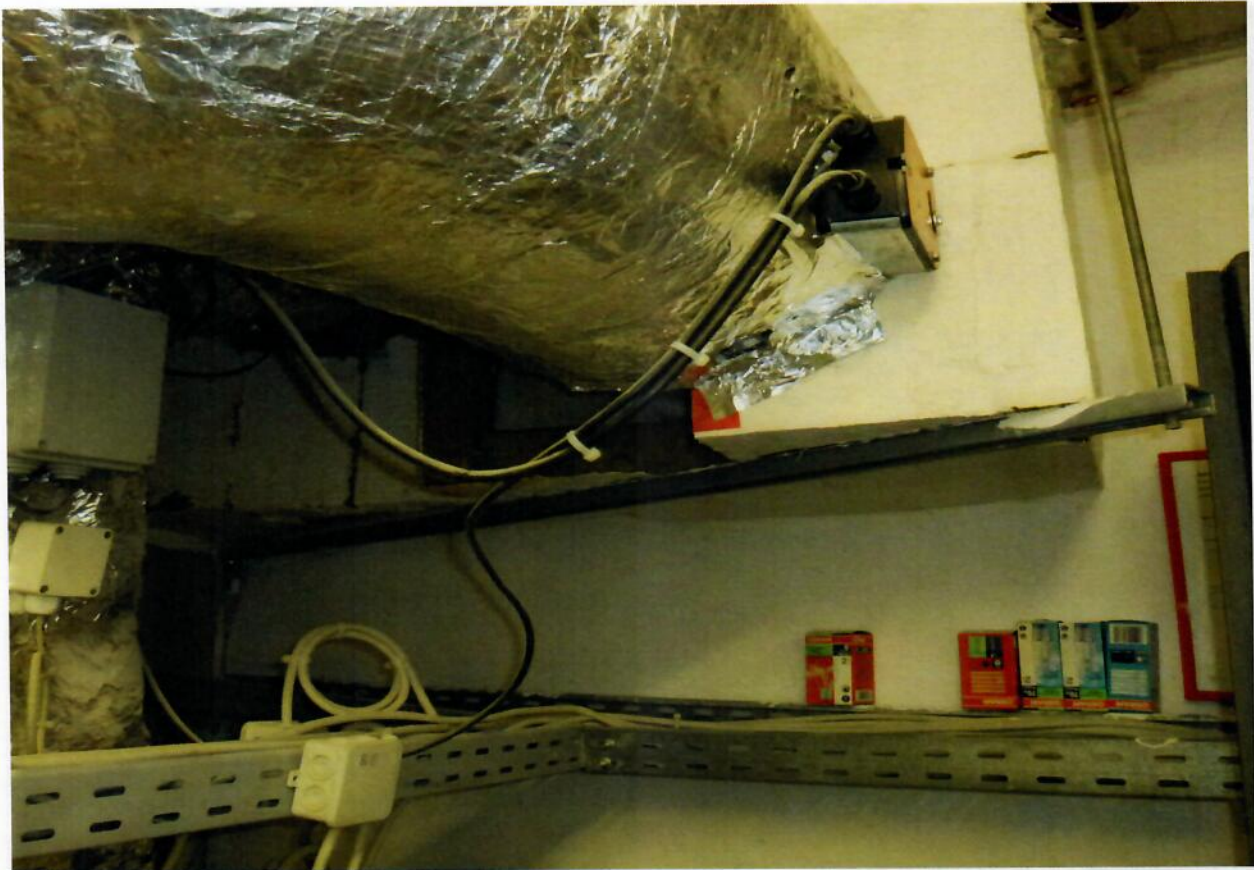
Foto 77_Lüftung 11: Brandschutzdurchführung Lüftung
