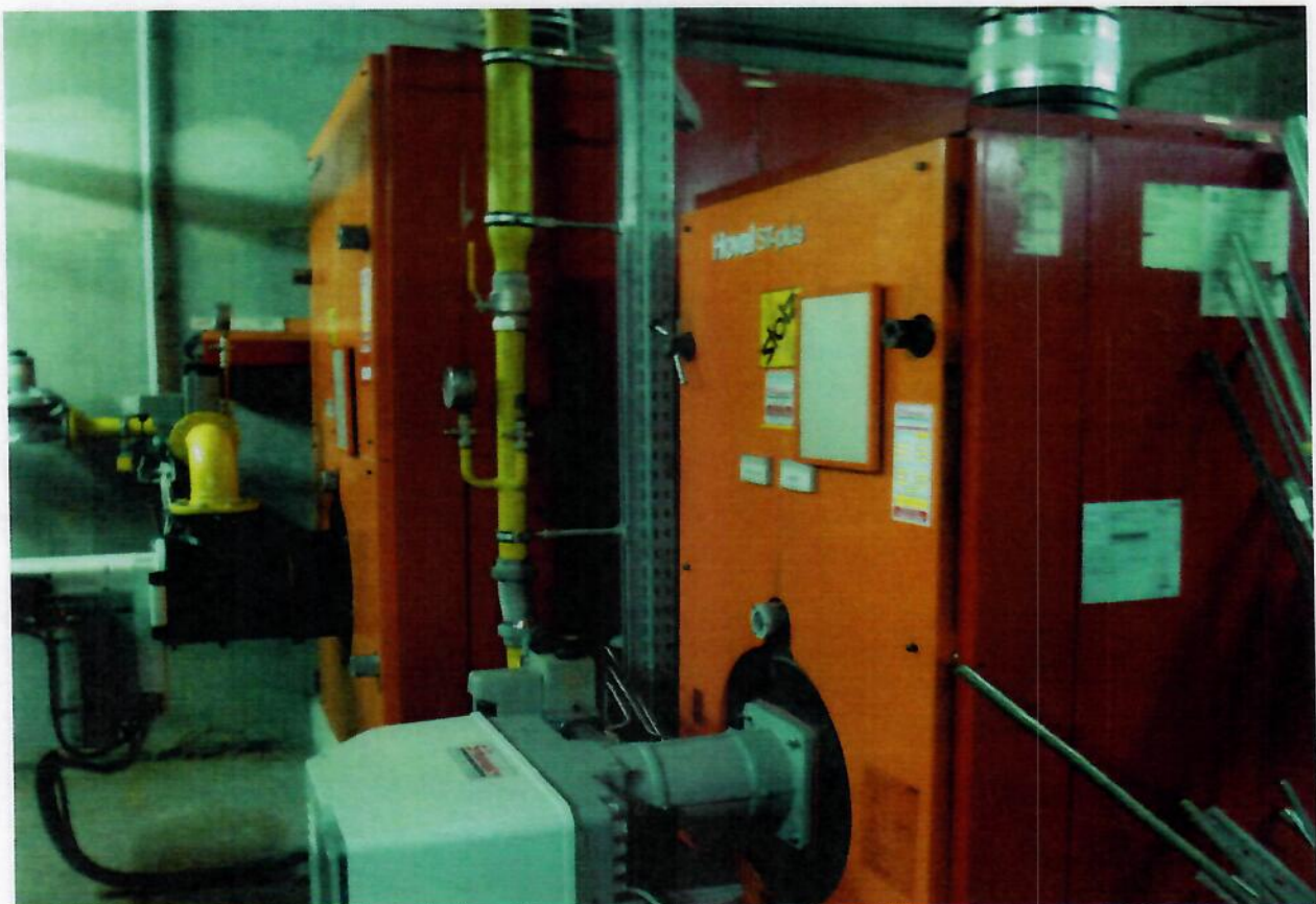
Foto 82_Heizung 12: Vorhandene Gasheizungsanlage
