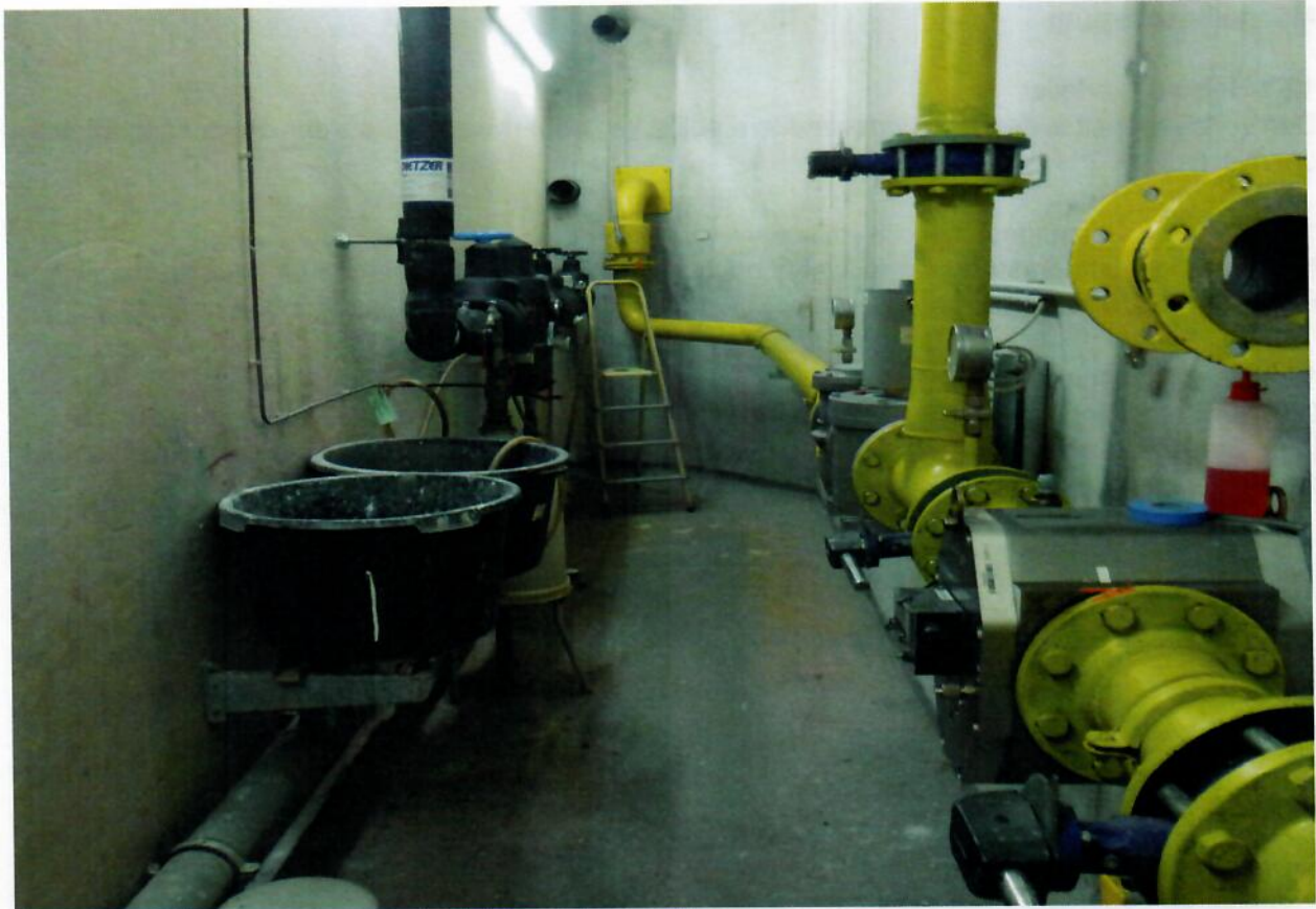
Foto 83_Heizung 12: Hauseinführung Gas
