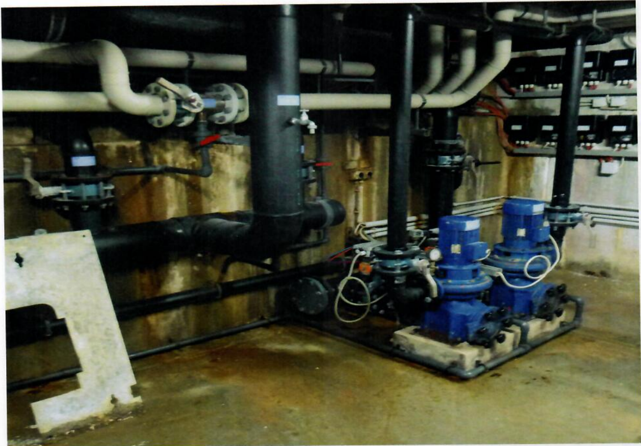
Foto 70_Badewassertechnik 10: Beckenverrohtung Bestand, Stellantriebe, Pumpen teilweise marode
