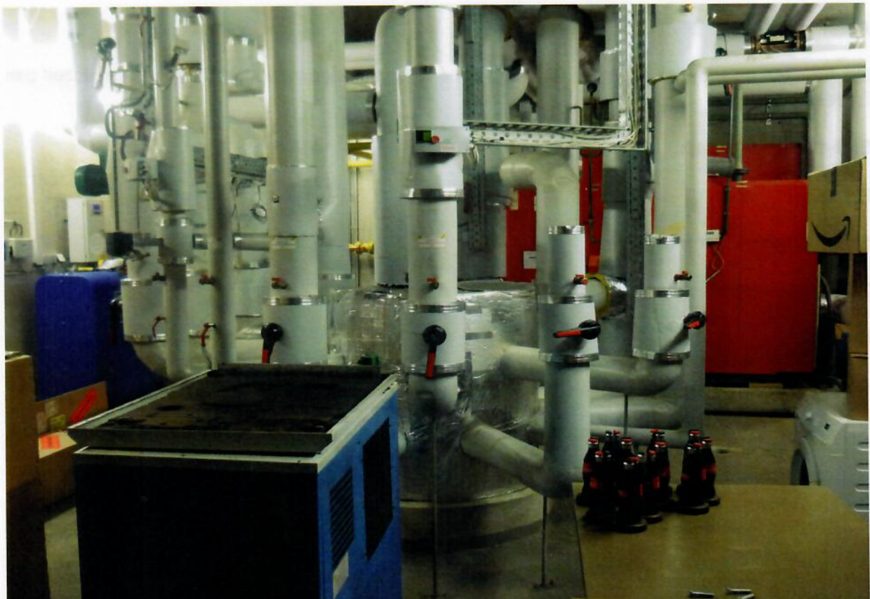
Foto 84_Heizung 12: Heizungsverteilung II
